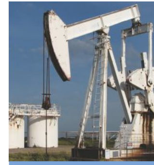
PUMP JACKS (PFERDEKOPFPUMPEN)
