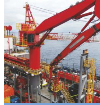
PLATTFORMKRANE UND SEILROLLEN
